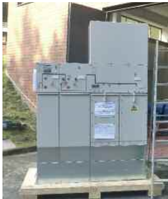
Schaltanlage für das Pumpwerk Honscheid
