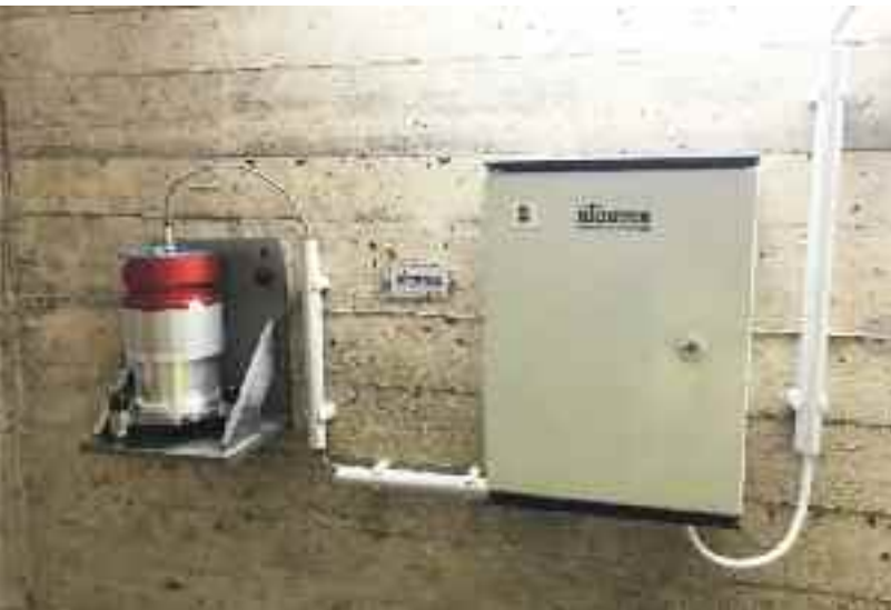
Mit der ergänzenden Neigungsmessung soll parallel erfasst werden, ob sich das Bauwerk bei einer möglichen Verschiebung auch neigt.
