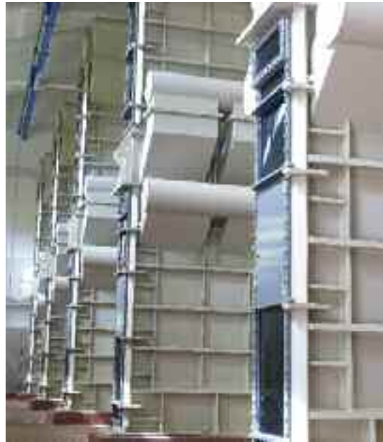
Riesleranlage im Betriebsgelände Pumpwerk Seligenthal
