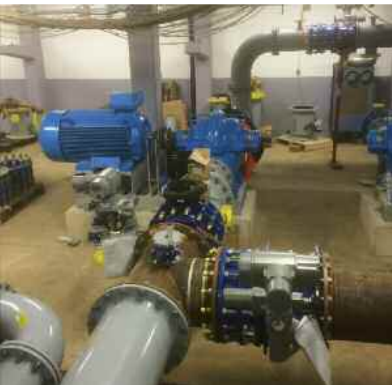
Neue Anlagentechnik im Pumpwerk Happerschoß
