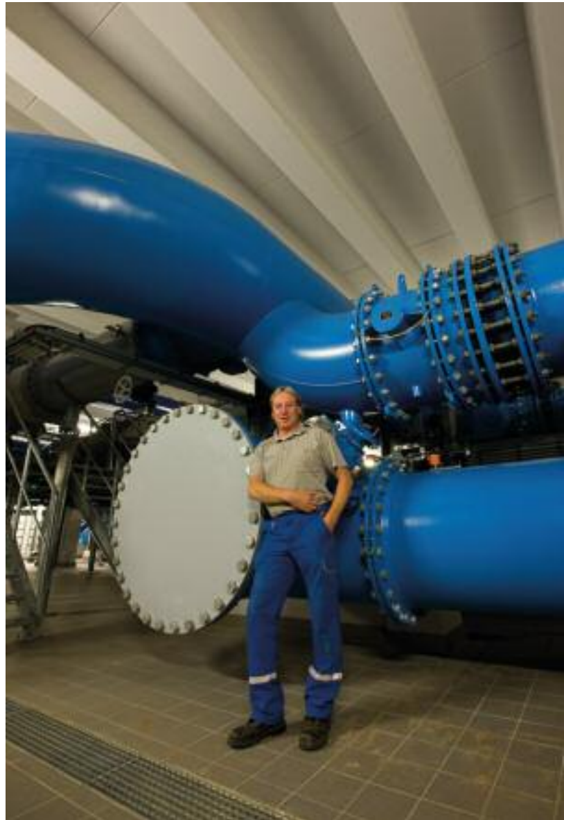
Trinkwasserleitungen im Rohrkeller der Trinkwasseraufbereitung der SN1
