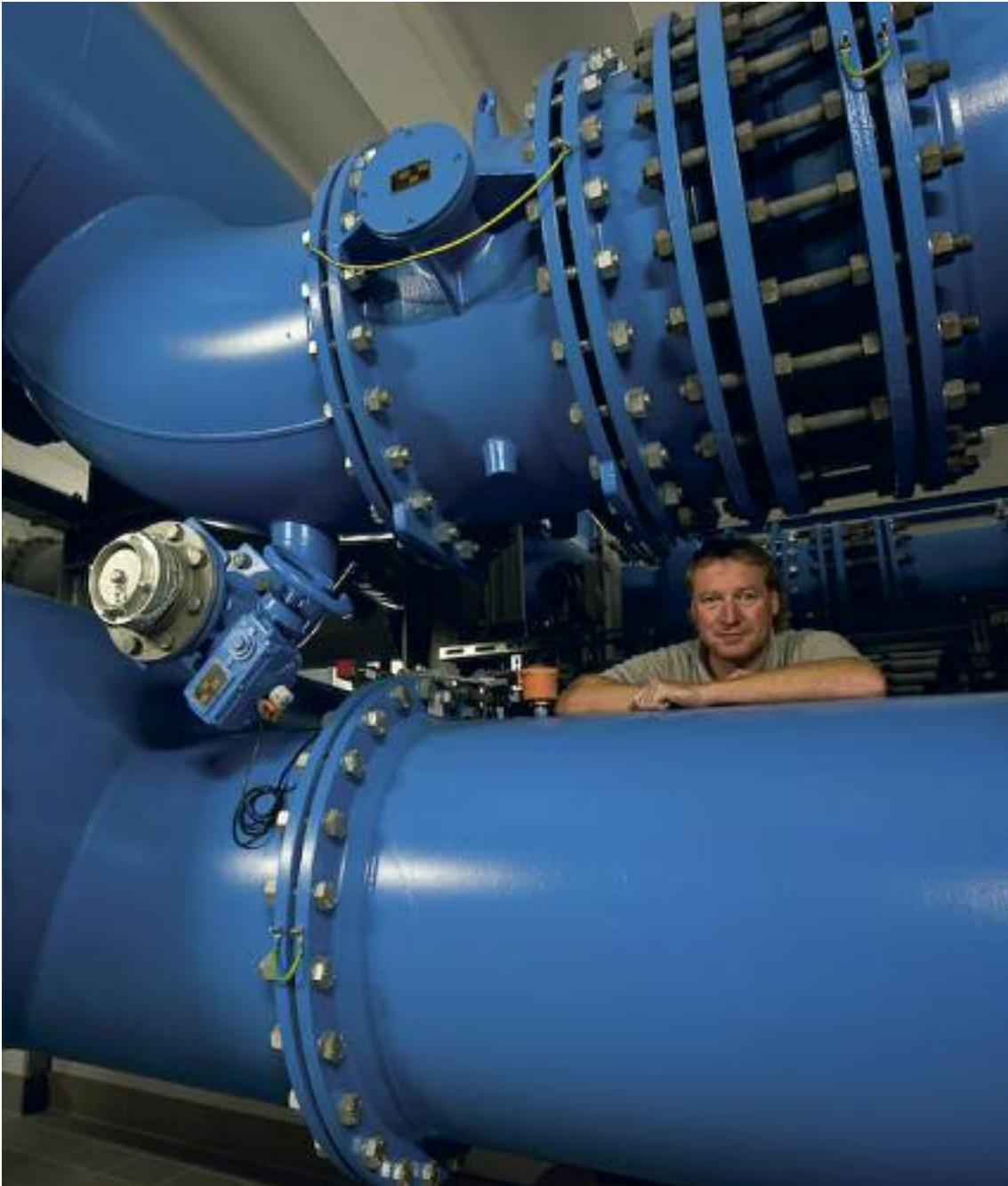
Trinkwassertransportrohre in Trinkwasseraufbereitung SN1.
