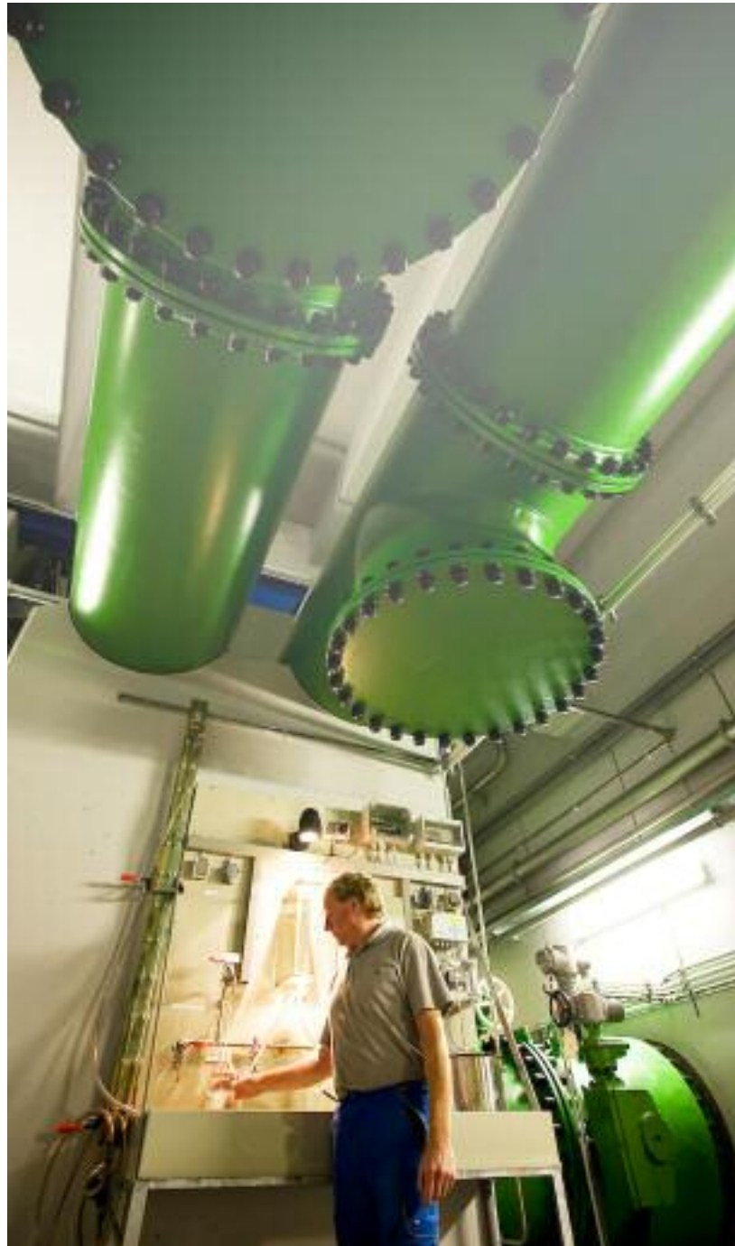
Wasserbank in der Aufbereitungsanlage für das Talsperrenwasser.
