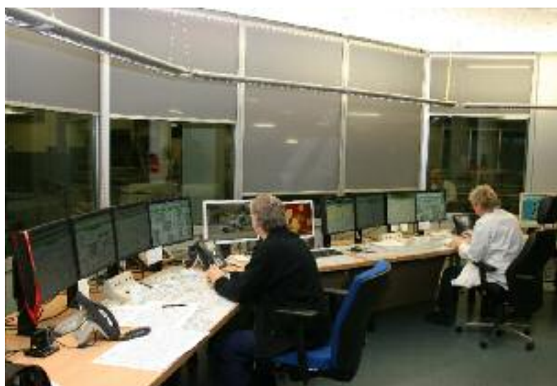
Zentraler Leitstand in der Trinkwasseraufbereitung Siegburg-Siegelsknippen.
